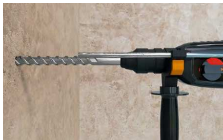
Fori su calcestruzzo.
