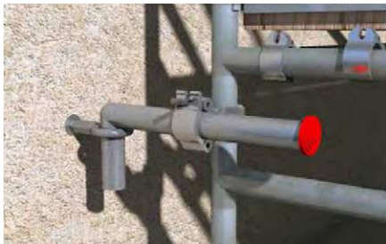
Ancoraggio Tubo A.
