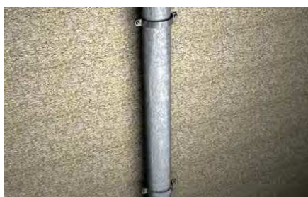
Pluviale a sezione circolare.
