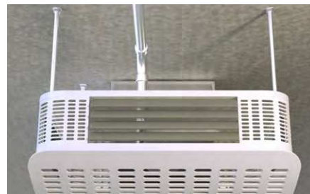
Unità di condizionamento.
