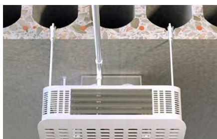
Unità di condizionamento su solai in calcestruzzo precompresso alveolare.
