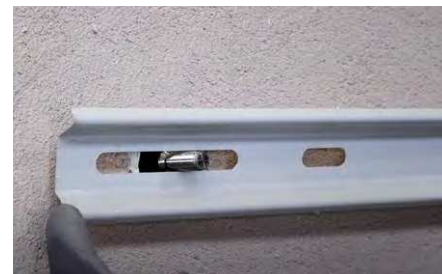
Condizionatori su parete a cappotto con Thermax Klima.
