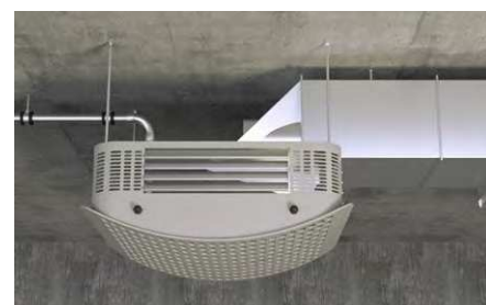
Unità di condizionamento aria.
