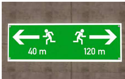
Segnali di uscita di emergenza in galleria.
